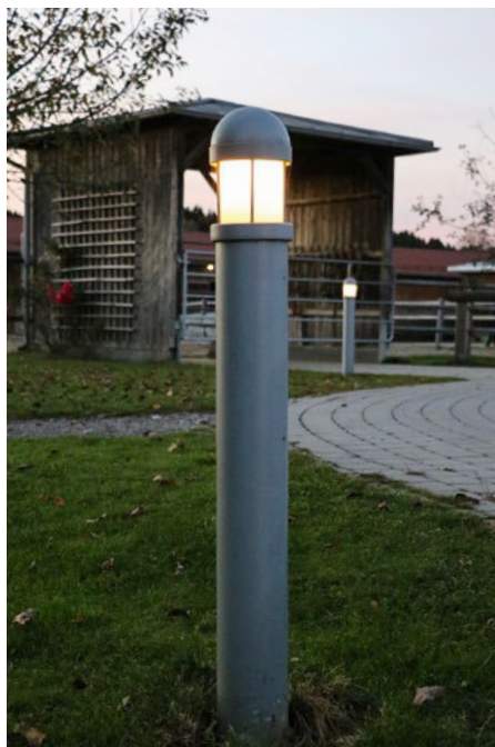
Besonders Lampen im Außenbereich müssen wind- und wetterfest sein.
